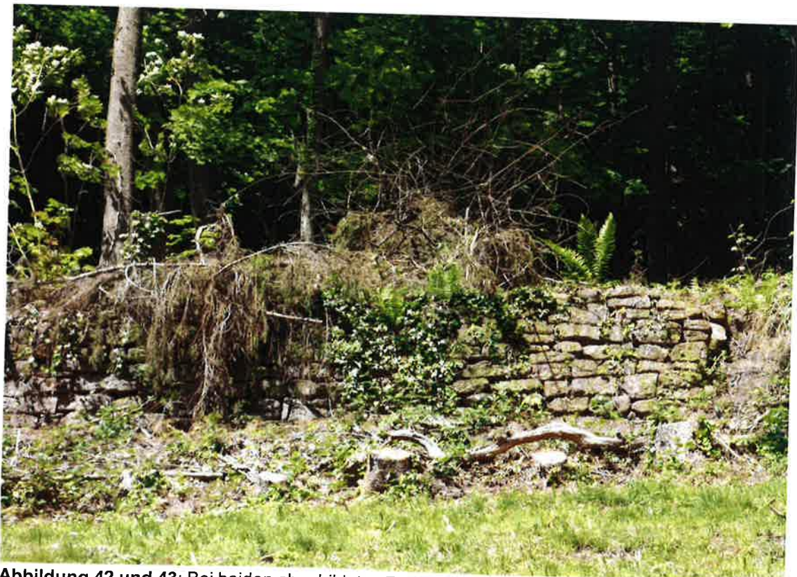
Abbildung 42 und 43: Bei beiden abgebildeten Trockenmauern sind wie auch bei vielen anderen Mauern des Gebietes Sanierungsmaßnahmen erforderlich. Der Bewuchs muss zurück geschnitten werden. Foto: 15.05.2019
