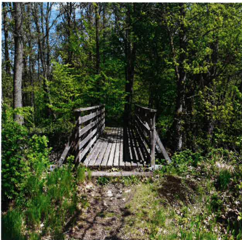
Abbildung 16 : Holzbrücke über den zweiten Ringwall von Royal Engineers 2005 gebaut, Foto: S. Wien, 30.04.2019
