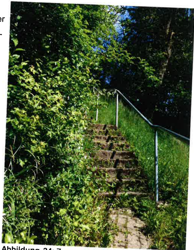
Abbildung 24: Zugewachsene Treppe im Südwesten mit Pflegebedarf, Foto: 15.05.2019
